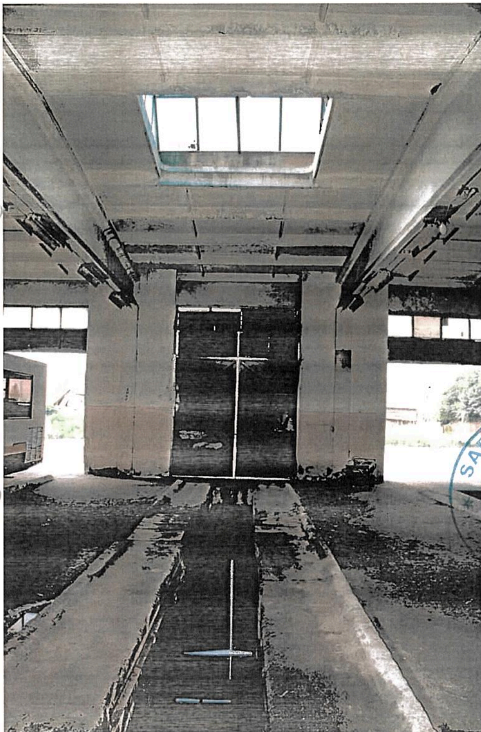
Canalele de lucru din hala de intretinere a autobuzelor
