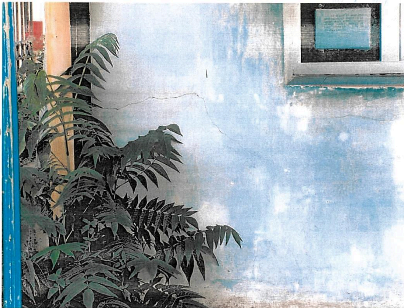
Fisura orizontala fatada vestica
